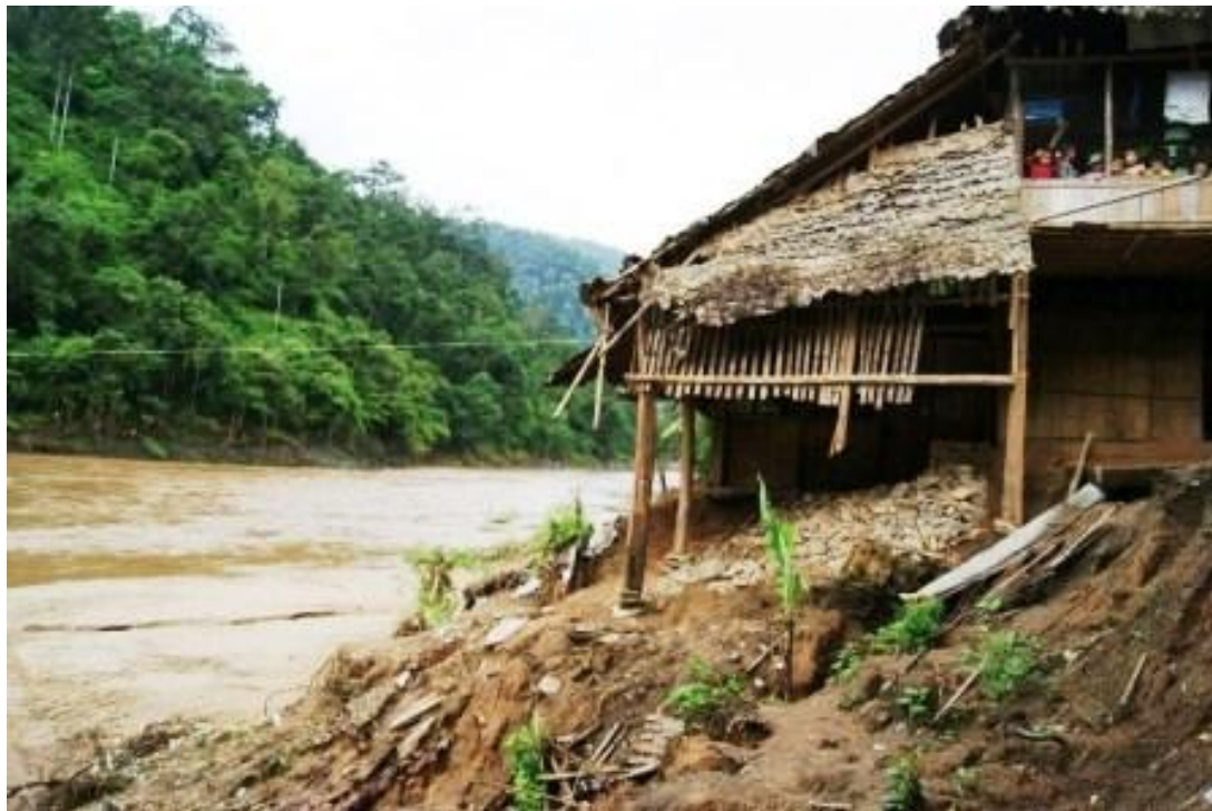
危険にさらされていた保育所。いつ崩れても不思議ではない建物に 100 名以上の児童が通っていた。
