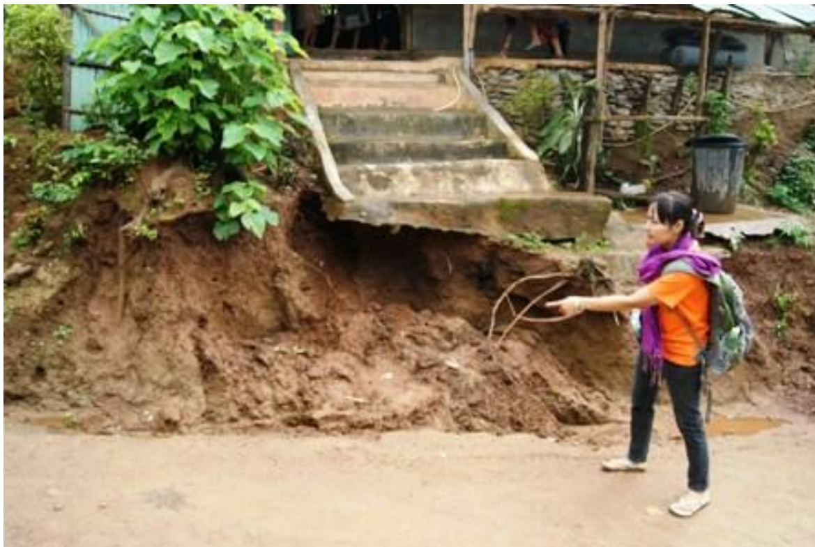
図書館に続く階段の土台が流されたため、図書館に行くことができなくなった
