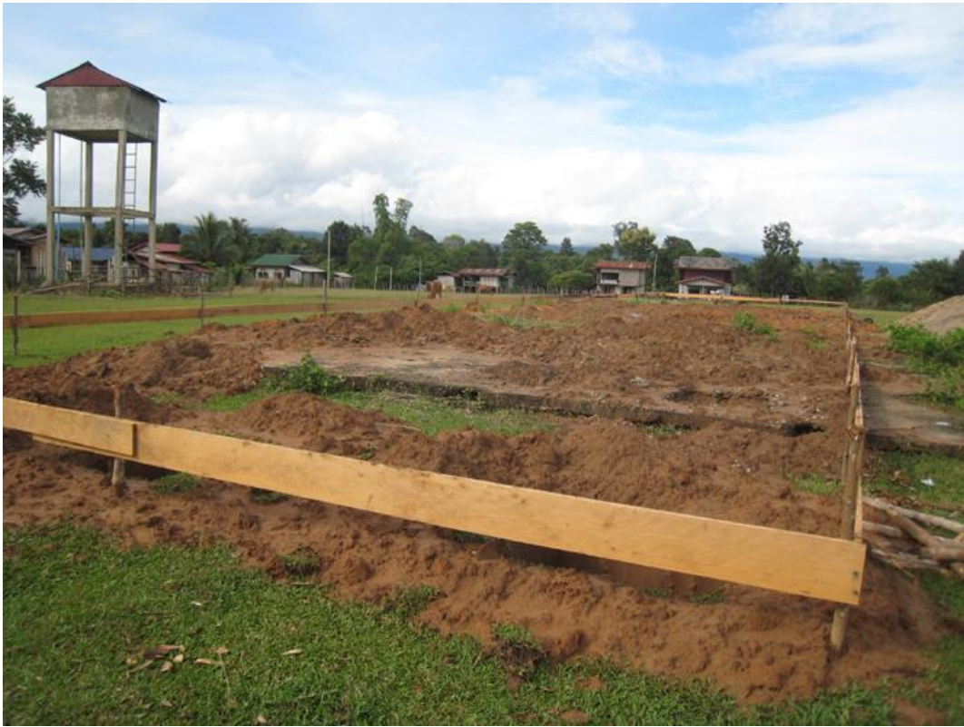
着工後間もなくの様子。建物の基礎となる柱を固定するための穴の掘削作業から入ります。
