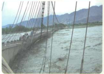
増水した水で村の橋が倒壊してしまった
