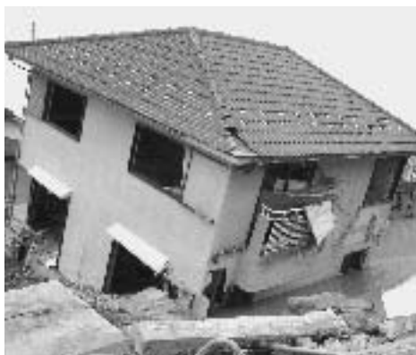
台風23号水害で被災した家屋
