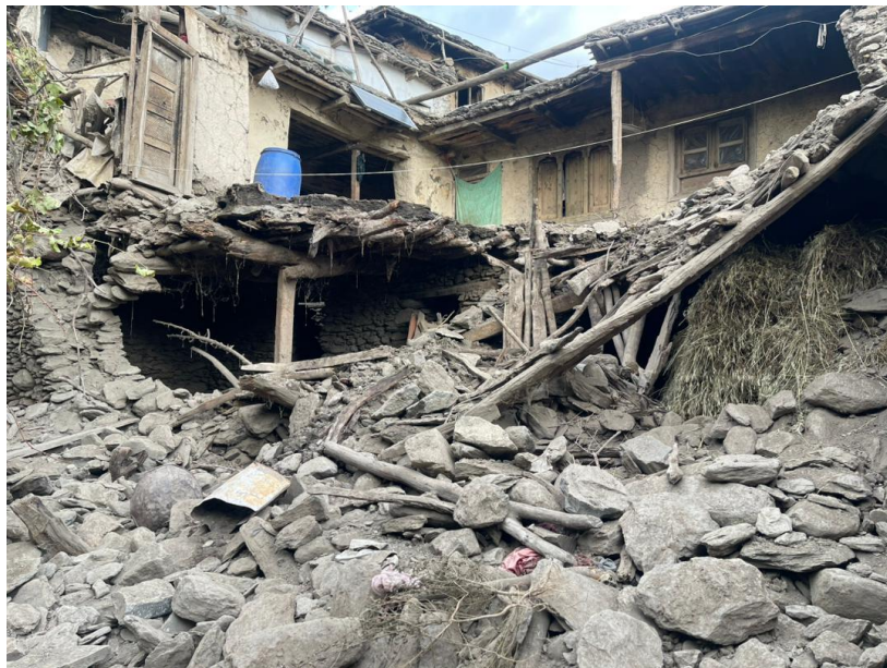
被害を受けた住宅（写真：連携団体からの提供）
