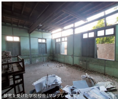
被害を受けた学校校舎（マンダレーにて）
