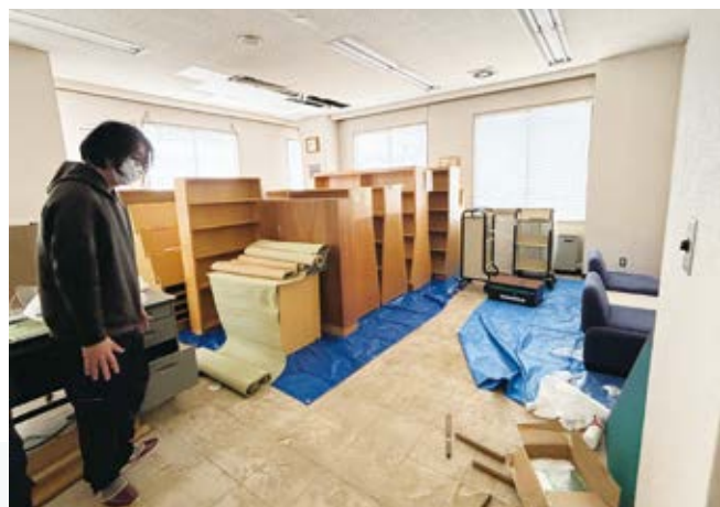
2024年9月の豪雨災害により浸水した町野図書館
